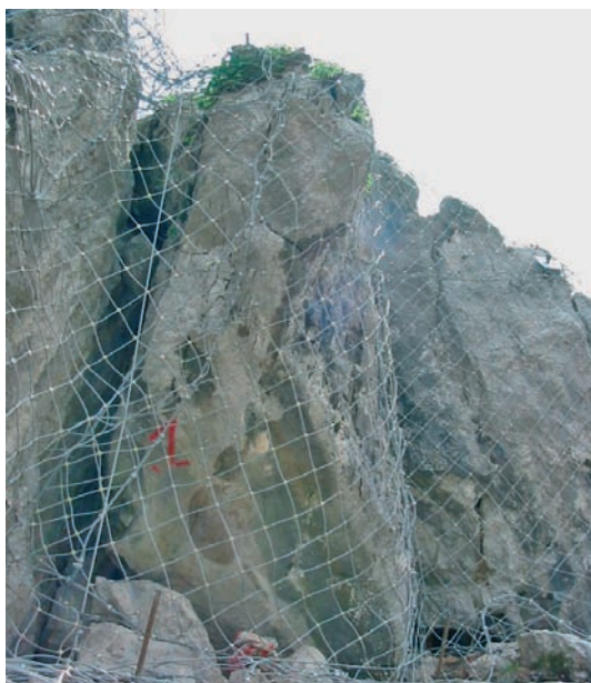
Fig. 26: Sabbio Chiese (BS), rete in aderenza su ammasso roccioso frantumato. Si possono osservare le fratture aperte e i sistemi di discontinuità leggermente piegati.
