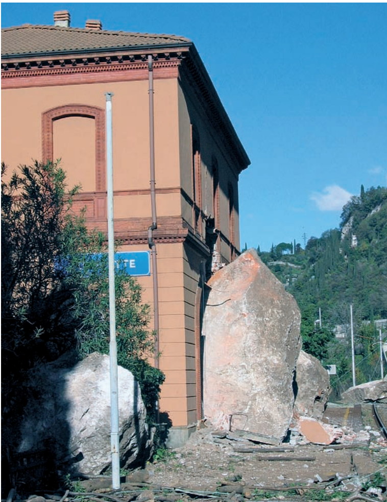
Fig. 23: Varenna (LC), grossi massi che hanno impattato sulla stazione ferroviaria di Fiumelatte a seguito del crollo del 13/11/2004.
