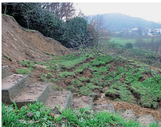
Fig. 39: Santa Maria Hoè (LC), particolare dell'accumulo dello scioglimento in terra avvenuto in seguito alle piogge del novembre 2002.
