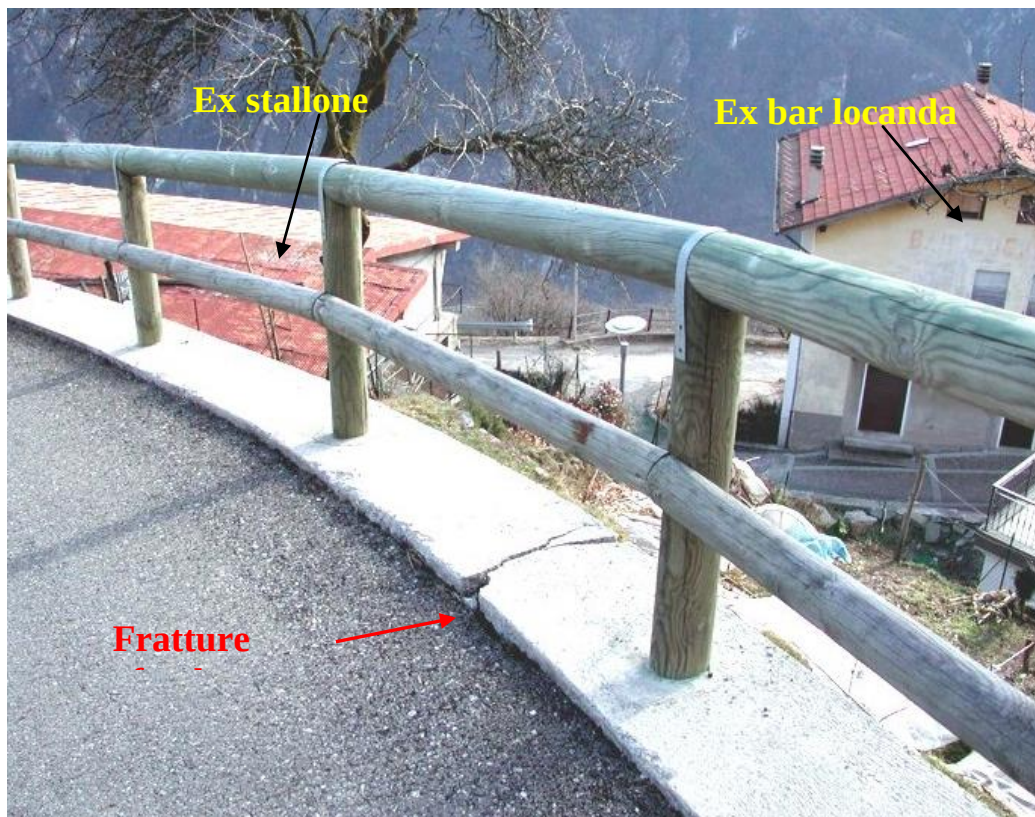
Fig. B102 - Panoramica ripresa da monte della porzione di versante compresa tra l'ex stallone e l'ex bar locanda, con in evidenza le fratture riconducibili al fenomeno franoso in atto.
